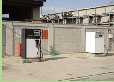
● 自家給油設備
